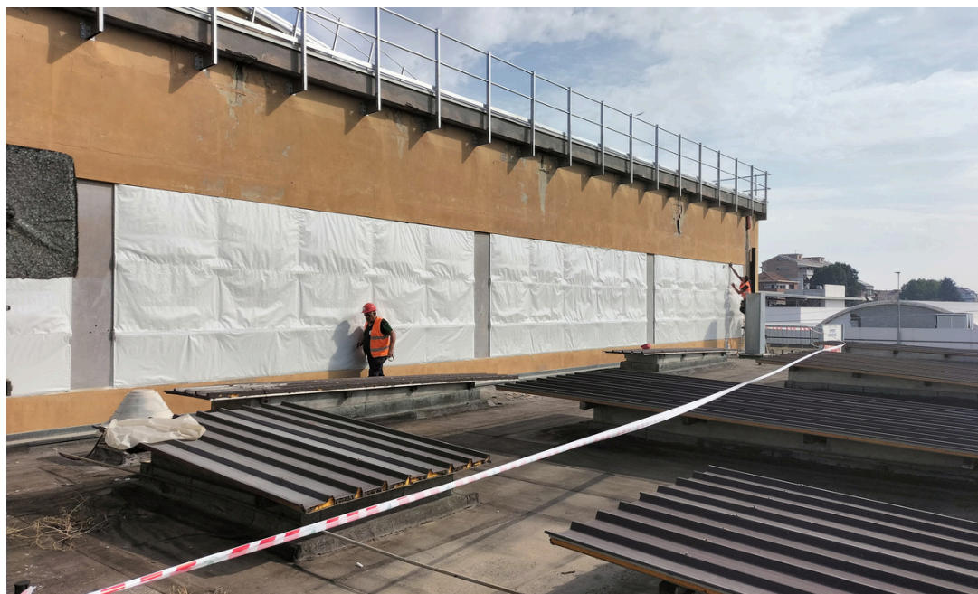
Sigillatura esterna serramenti con mastice in amianto friabile
